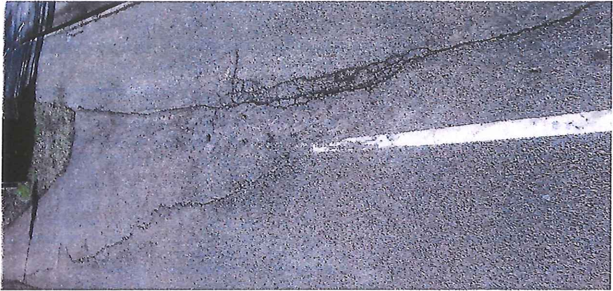
Här har lganing gjorts utan all linjen har fyllts i. Det gör det inte lätt att veta var man ska cykla.
